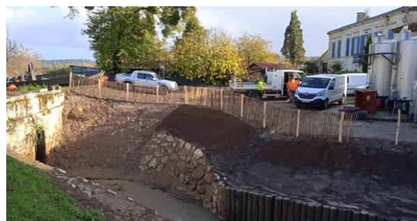
Rouille de Boutric à Pont Castel
